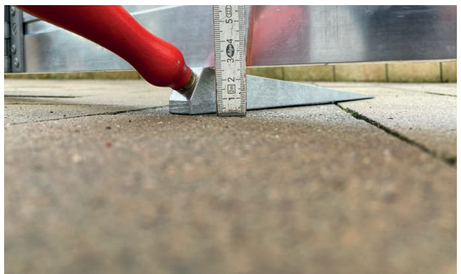
Unebenheiten im Pflaster sind mit dem passenden Werkzeug leicht nachweisbar. Hier liegt die Abweichung der Ebenheit unter der 4,00 m Alu-Richtlatte bei über 25 mm. Das ist ein zu großer Wert.
