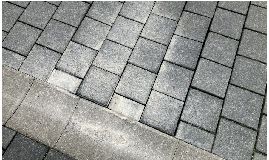
Ein klassisches Schadensbild einer wasserundurchlässigen Tragschicht. Hier wurde das Pflaster durch uns aufgenommen und mit einem Versickerungsversuch die Wasserundurchlässigkeit und somit eine Abweichung vom Regelwerk nachgewiesen.
