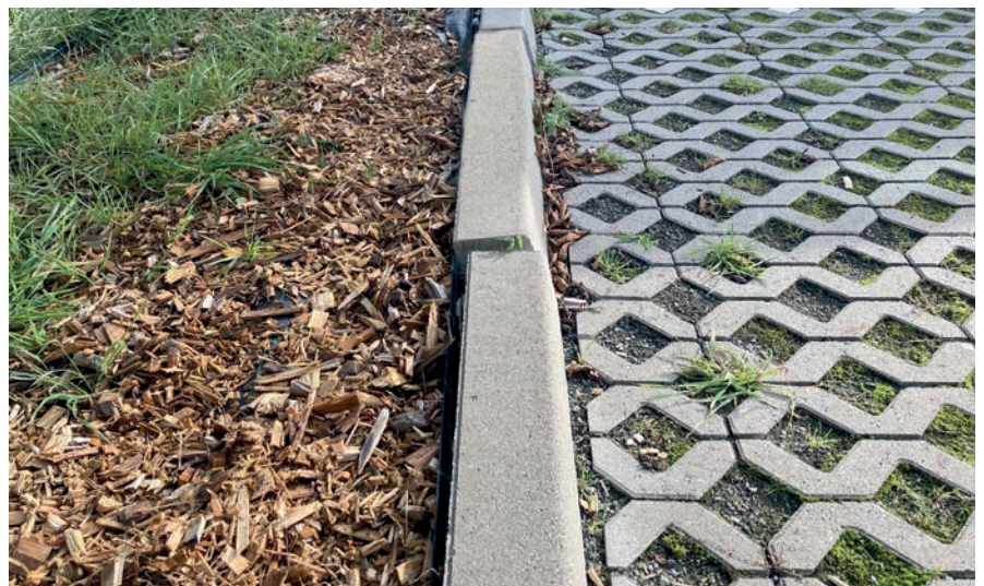
Umgefahrene Bordsteine am Ende einer Parkplatzfläche aufgrund einer vom Regelwerk abweichend hergestellten Betonrückenstütze.
