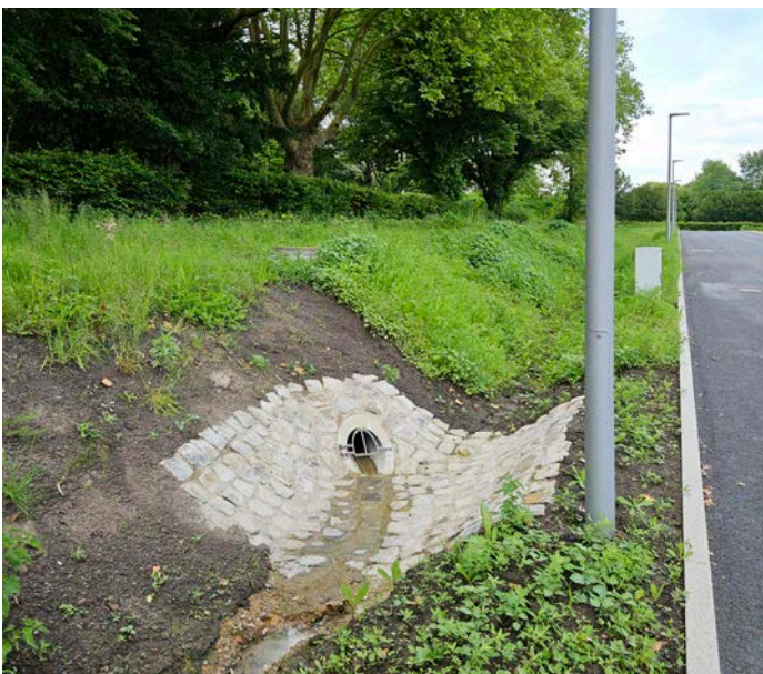
Regenwasserableitung von bewachsener Mulde
