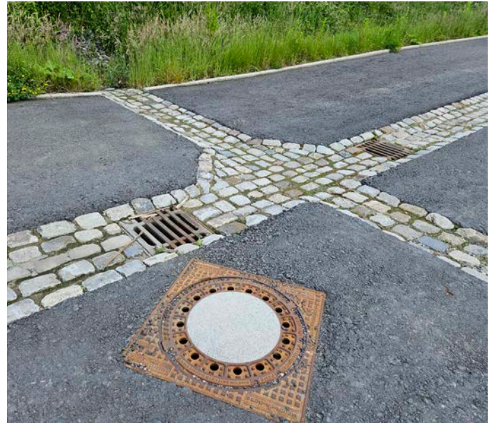
Wasserführung auf der Fahrbahn über Muldenrinnen
