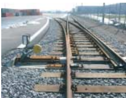
Um jederzeit einsatzfähig zu sein, wurde jede der vier Weichen im BMW Dynamikzentrum mit einer Weichenheizung ausgerüstet.
